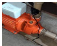
Figura 12 - Local de instalação do sensor.
