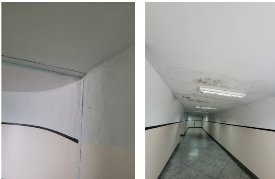
Figura 3 - Manifestações patológicas causadas pela infiltração da cobertura
