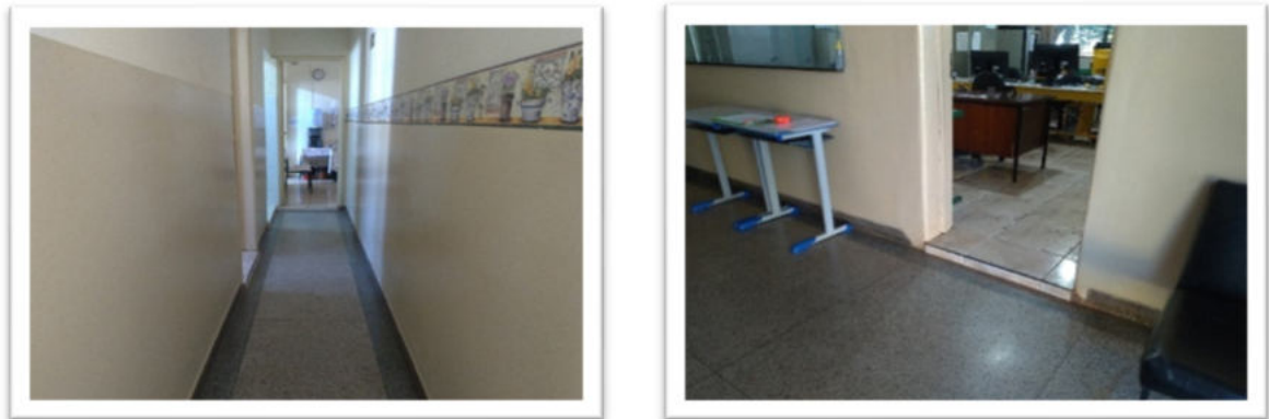
Figura 9 e Figura 10 – Corredores do colégio 3 com desnível de acesso para as salas
