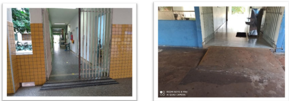
Figura 11 e Figura 12 – Pisos inclinados forma de norma nos colégios 2 e 4
