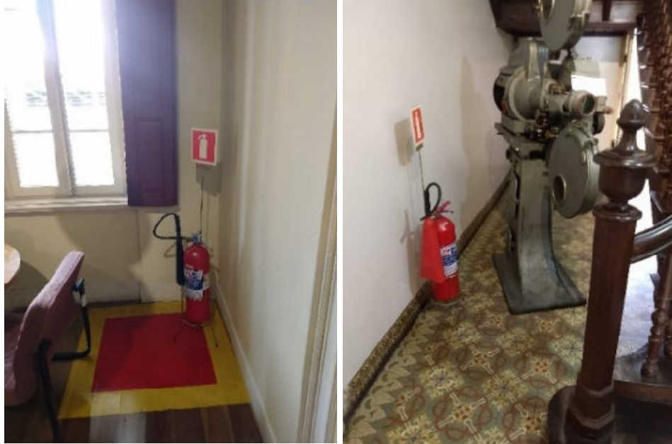
Figura 2 - Extintores em áreas expositivas, reserva técnica e administrativa
