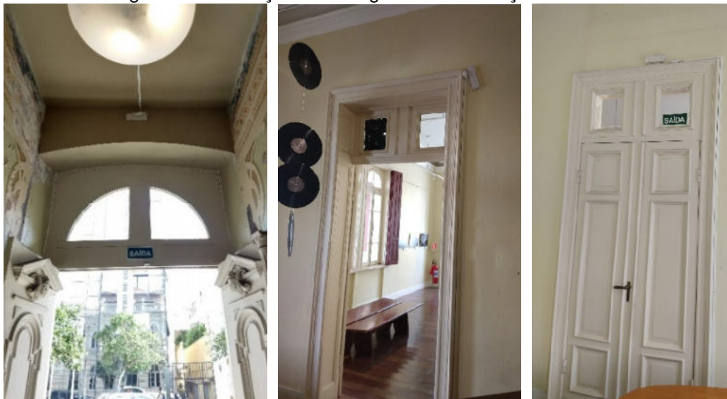
Figura 3 – Iluminação de emergência e sinalização de saída
