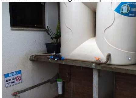
Figura 9 – Identificação da torneira de água não potável
