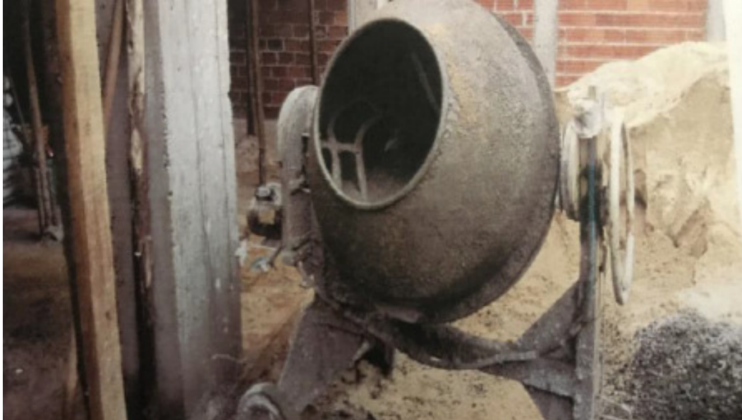
Figura 5 – Falta de proteção ao maquinário
