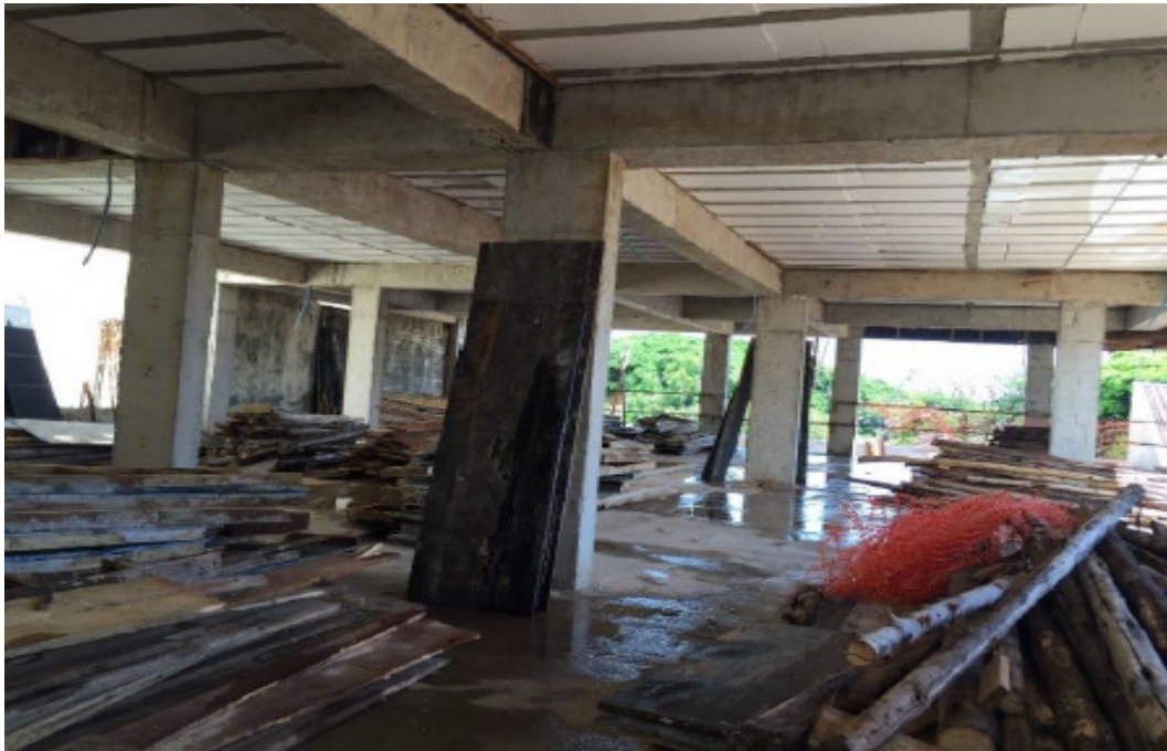
Figura 4 – Saliências e depressões que prejudicam a circulação dos trabalhadores
